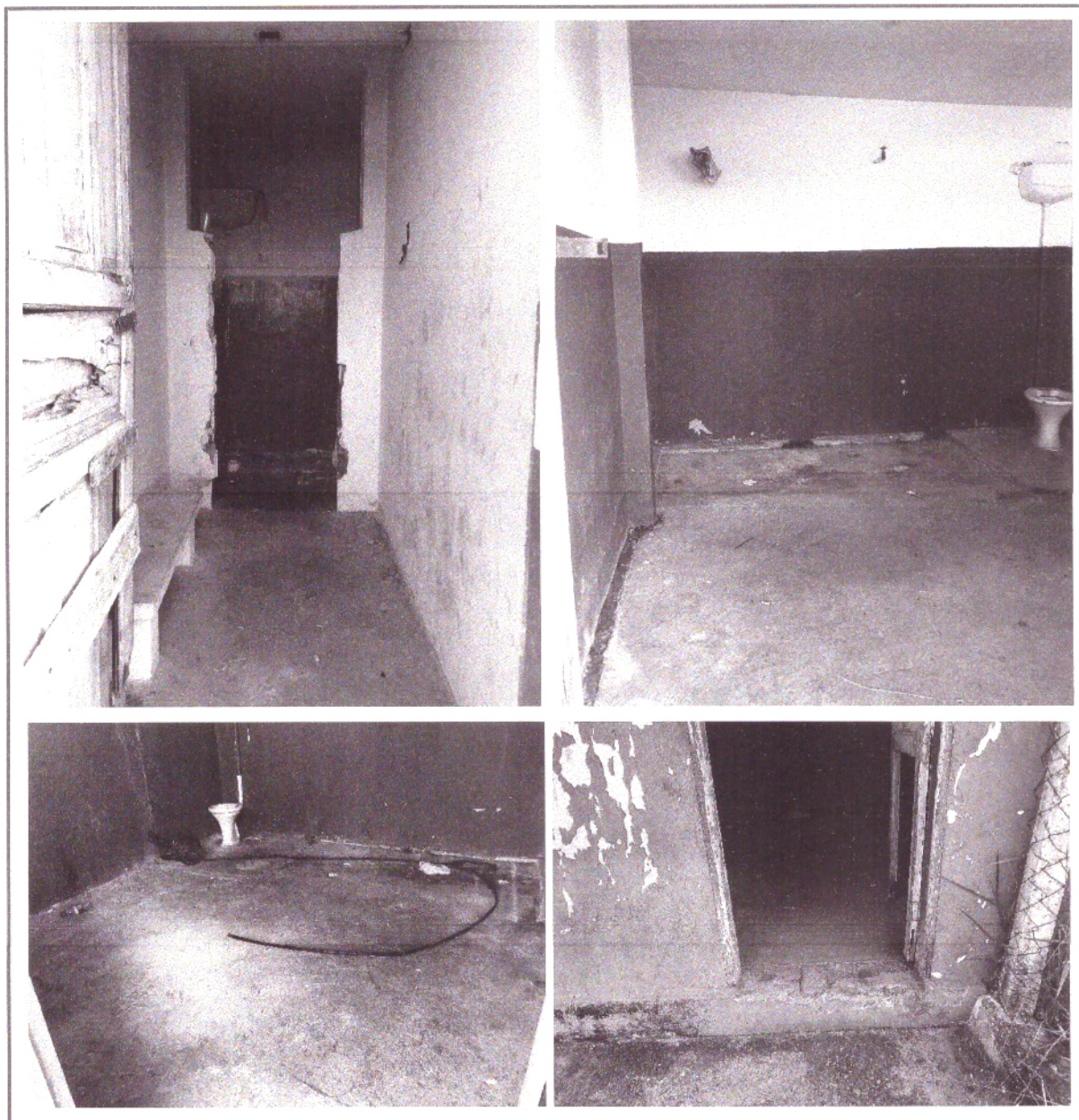
Figura 12 – Piso dos vestiários
